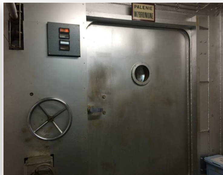
Drzwi wejściowe do reaktora
